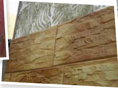
← Źle przygotowane podłoże nieusunięte stare powłoki farb (m.in. olejnej) + warstwa kleju powyżej 1 cm.
