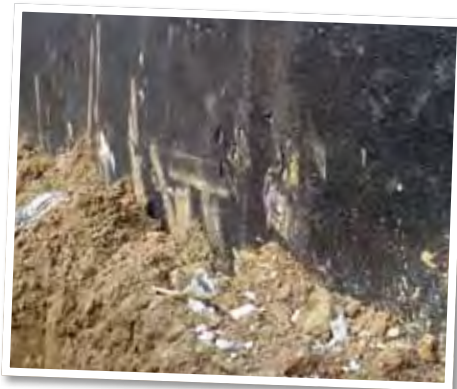
FOT. 2. Prawidłowo wykonana izolacja bardzo często ulega zniszczeniu na etapie zasypywania wykopu. Zanieczyszczenie powodują trwałe i niewidoczne nieszczelności – ważnym jest stosowanie zabezpieczeń przed takimi uszkodzeniami w postaci płyt termoizolacyjnych lub przynajmniej folii, tzw. kubelkowej.
