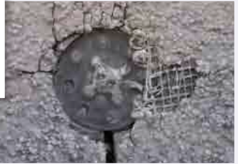
FOT. 9 Wymagania dotyczące mocowania płyt styropianowych za pomocą łączników mechanicznych nie zostały spełnione, użyto bowiem kołków z trzpieniem tworzywowym o zbyt małej długości, która nie gwarantowała ich właściwego zakotwienia.
