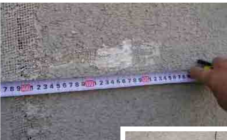
FOT. 12 Nie przestrzegano zasady stosowania minimalnych zakładów pasów siatki, a w niektórych miejscach siatkę zamontowano, pozostawiając niepokryte pola.
