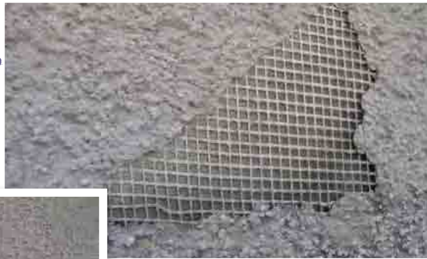
FOT. 11 Wskutek złego zatopienia siatki zbrojeniowej w masie szpachlowej powstało na powierzchni elewacji wiele miejsc, gdzie siatka odspoiła się i odpadł tynk.
