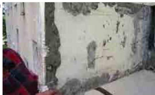
FOT. 6 W wielu innych miejscach styropian przyklejano wprawdzie metodą obwodowo punktową, lecz klej rozkładano niedbale i w zbyt małej ilości.
