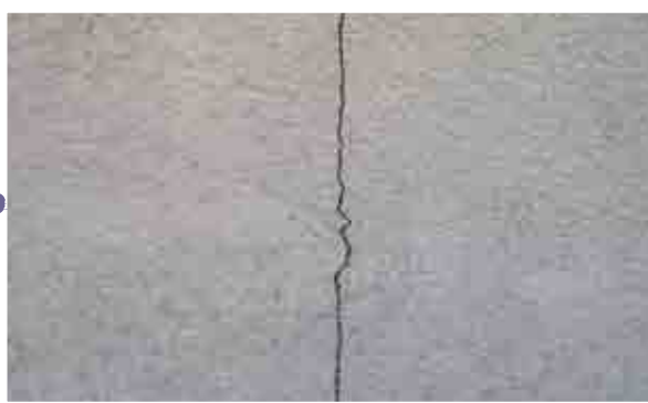
FOT. 14 Nieprawidłowo wykonano ocieplenie w strefie dylatacji pionowej (pomiędzy sekcjami bloku). W efekcie wytworzyło się samoczynnie pęknięcie o nieregularnym przebiegu.
