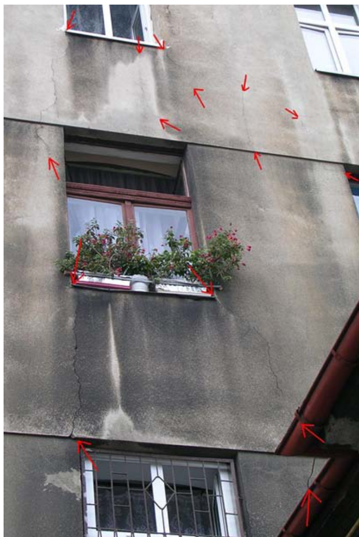
Fot. 2. Elewacja murowanej kamienicy z drewnianymi stropami po remoncie polegającym na wymianie polepy na wełnę mineralną. Widać zarysowania nadproży i podokienników powstałe na skutek poluznienia umocowania belek stropu drewnianego w gniazdach muru
