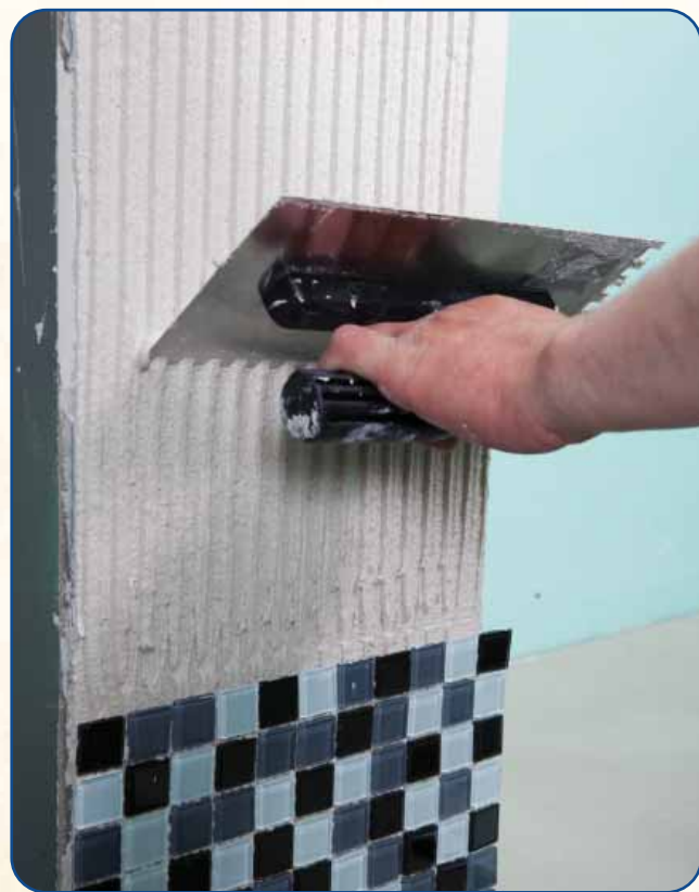
Fot. 2. Zbyt gruba warstwa kleju przy przyklejaniu mozaiki może spowodować zapadanie się kostek mozaiki, wypływanie zaprawy ze szczelin i efekt falowanej powierzchni, która nie utworzy idealnej płaszczyzny.
