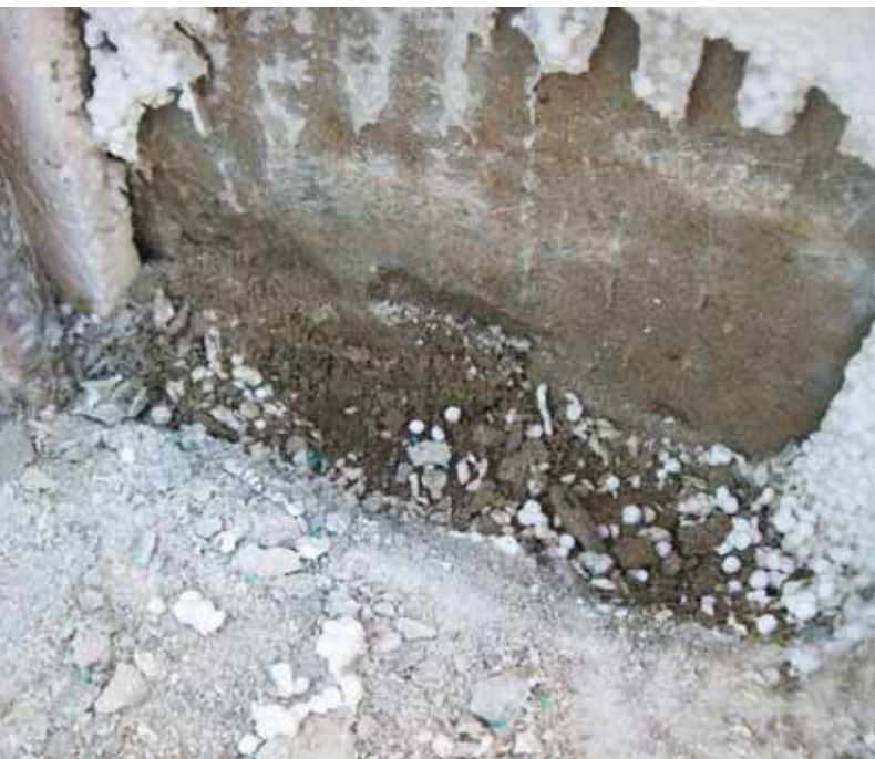
Fot 1. Po wycięciu styropianu okazało się, że pod nim jest znaczna wilgoć.
