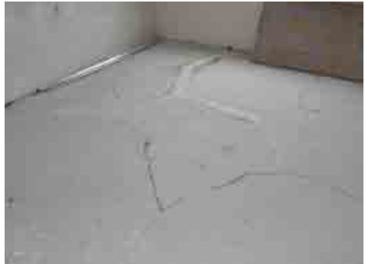
Fot. 6. Na zdjęciu widoczne są wąskie rysy skurczowe (poniżej 1 mm), nacinane i wypełnione żywicą epoksydową, oraz szerokie pęknięcia, wycinane i uzupełniane jastrychem na warstwie szepnej.
