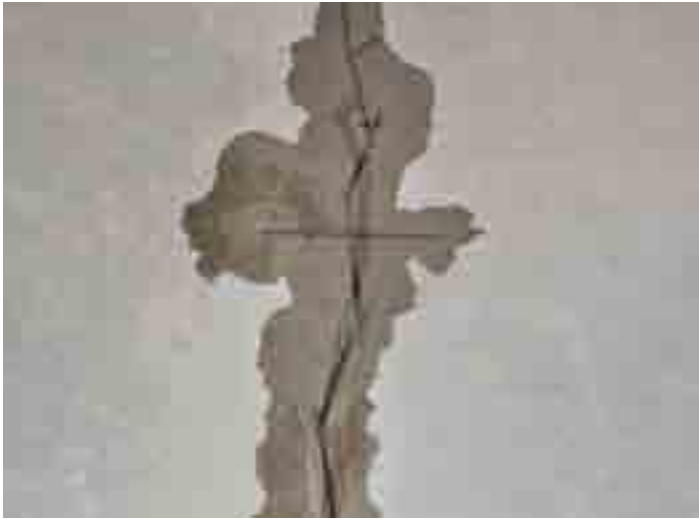
Fot. 4. Spękania skurczowe w podkładzie cementowym spowodowane prawdopodobnie błędnym wykonaniem dylatacji, brakiem pielęgnacji podkładu lub przelaniem wody. Spękania zostały nacięte szlifarką kątową i wypełnione żywicą epoksydową.
