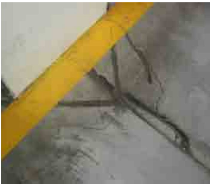
Fot. 2. Spękania posadzki przemysłowej w pobliżu słupa konstrukcyjnego. Samoczynne pęknięcia powstały w sąsiedztwie prawdopodobnie nieprawidłowo wykonanych dylatacji pierwotnych.
