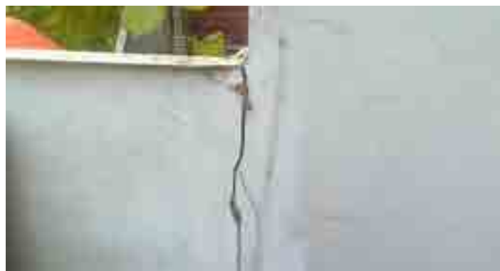
Fot. 3. Tąpnięcie płyty tarasowej wskutek braku wyobraźni poprzedniego wykonawcy.
