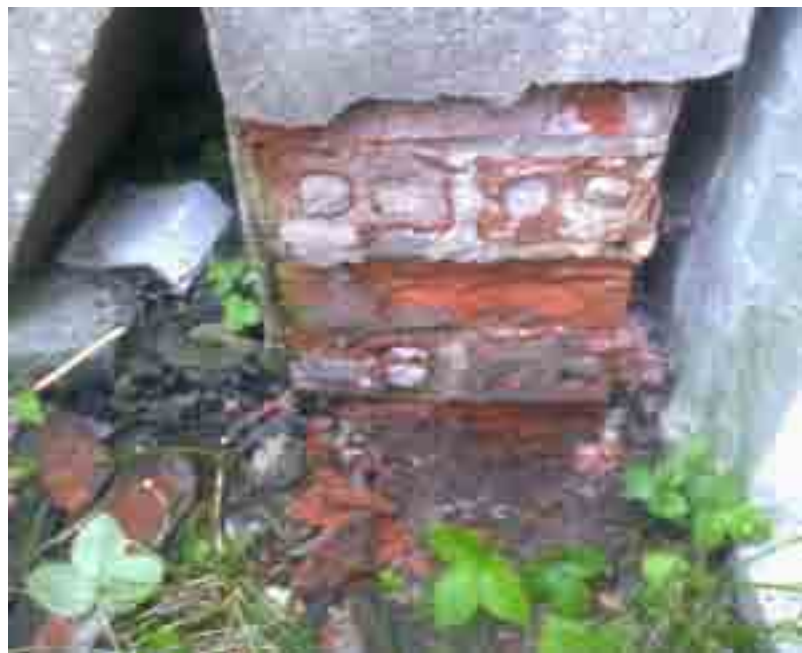
Fot. 5. Słupy oporowe zostały postawione wprost na ziemi, bez żadnego fundamentu.
