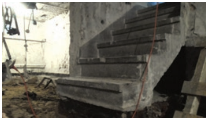
Fot. 1. Usadowienie wylewki (pozostała część widoczna pod schodami) i schodów w piwnicy. Widać brak izolacji i... zdrowego rozsądku. Zauważalne są natomiast ślady po izolacji ławy fundamentowej.
