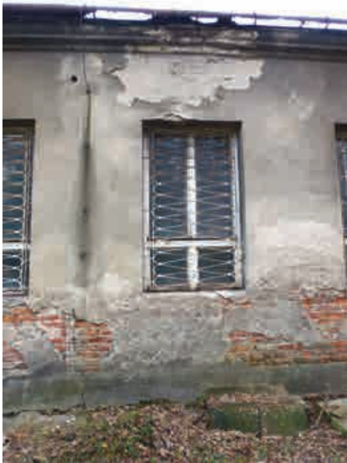
Fot. 4. Widoczne zniszczenie solami tynków w strefie cokołowej i uszkodzenia strefy gzymsu od dziurawych rynien. Wyraźnie widoczny zasięg podciągania kapilarnego. Do renowacji wykorzystano tynki renowacyjne Złoty Wiek.
