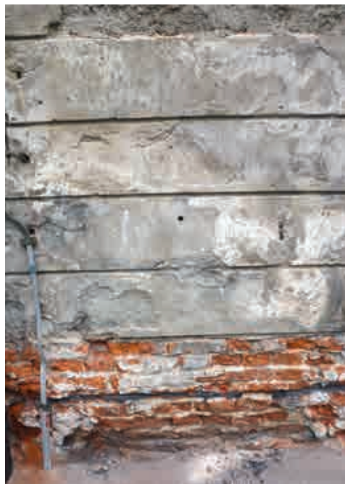
Fot. 5. Cytadela warszawska. Widoczne wysolenia od podciągającej kapilarnie wody. Zniszczenie tynków solami.
