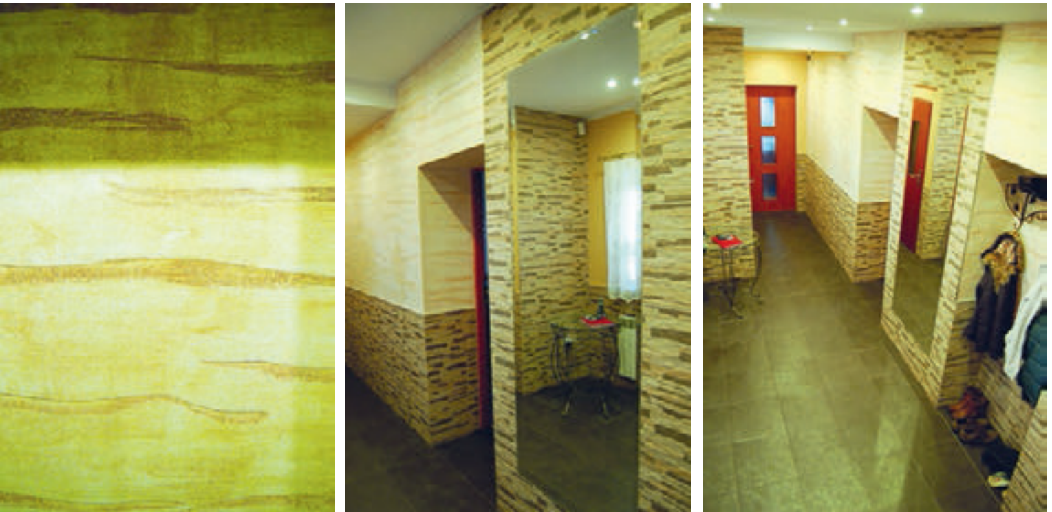
Fot. 4, 5 i 6. Wżery i spękania zostały podkreślone naniesieniem na powierzchnię ściany warstwy ciemnego lakieru
