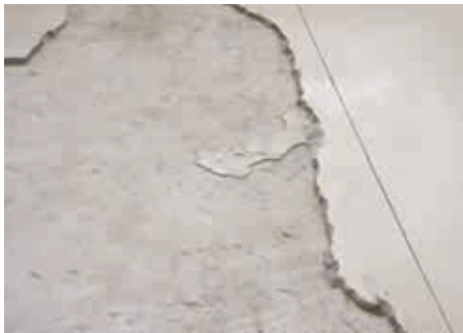
Fot. 3. Spękania i odspojenia warstwy podkładu o zbyt małej grubości
