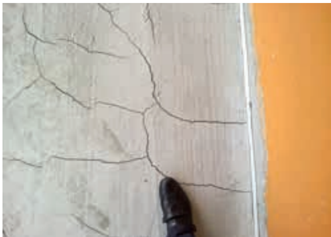
Fot. 6. Spękania podłoża
