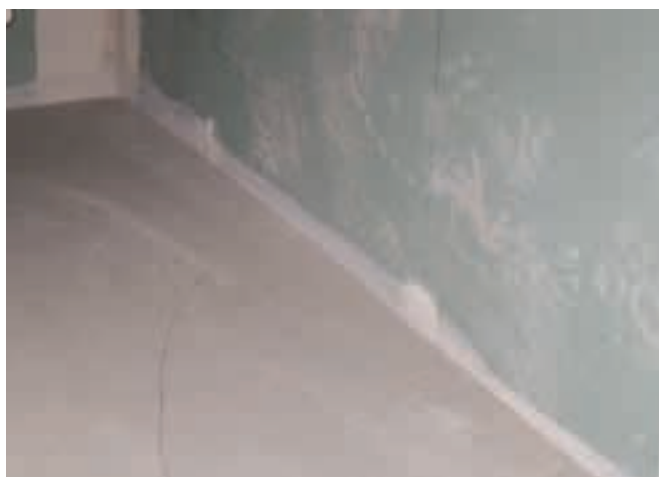
Fot. 5. Spękania skurczowe podkładu podłogowego. Widoczny brak dylatacji obwodowej wzdłuż ścian
