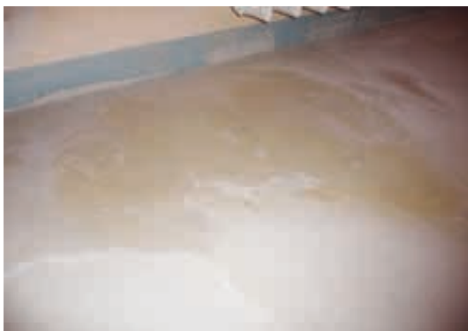
Fot. 7. Przykład zastosowania zbyt dużej ilości wody technologicznej, podkład anhydrytowy ma niejednorodny kolor będący wynikiem wypłukania dodatków chemicznych
