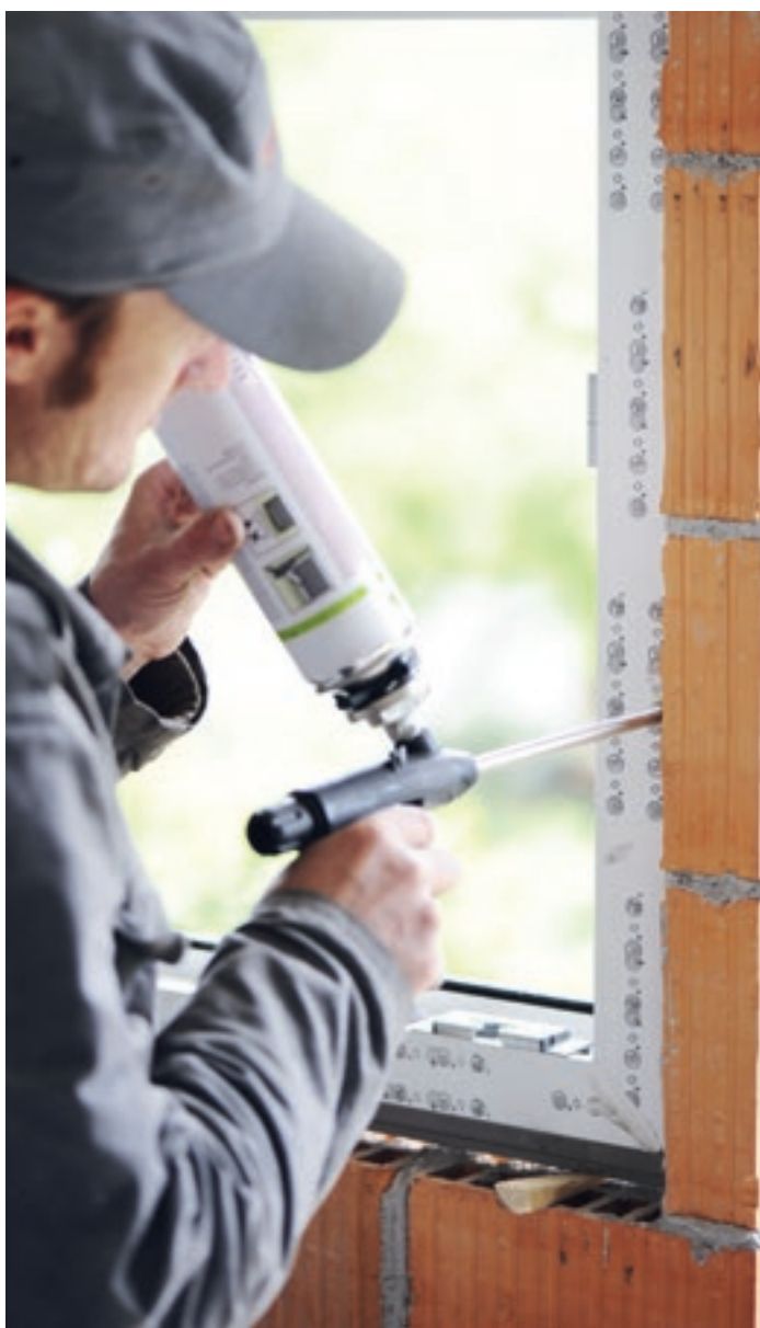
Fot. 1. Zbyt duże użycie pianki montażowej może spowodować odkształcenia okna
