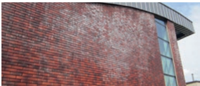
Fot. 2. Jedną z przyczyn nalotów są różnice temperatur i wilgotności wewnątrz i na zewnątrz muru
