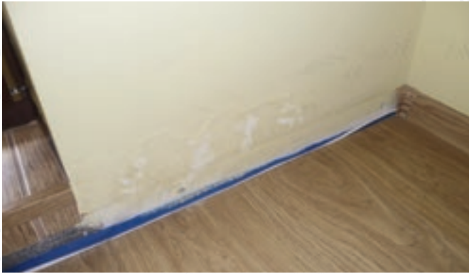
Fot. 2. Błędy w uszczelnieniu powodują zawilgocenie strefy przypodłogowej
