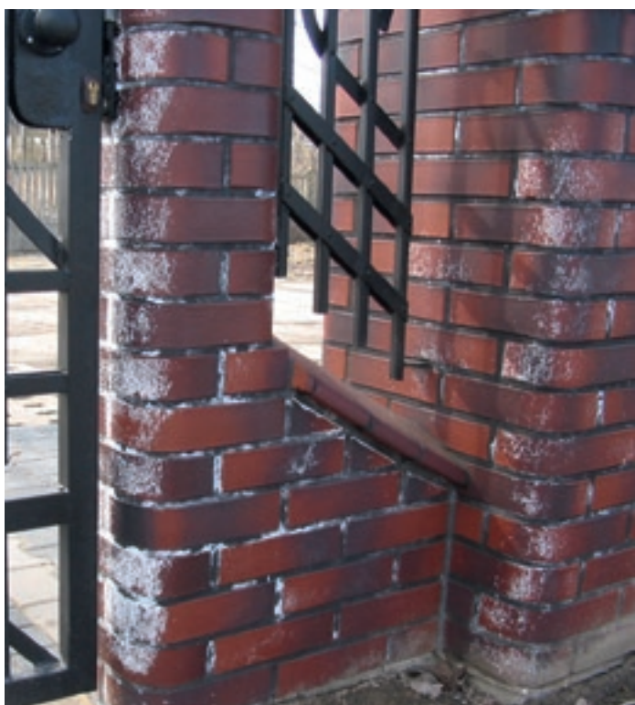
Fot. 1. Zwyczajnie wykwyty powstają, gdy w murze znajdują się sole
