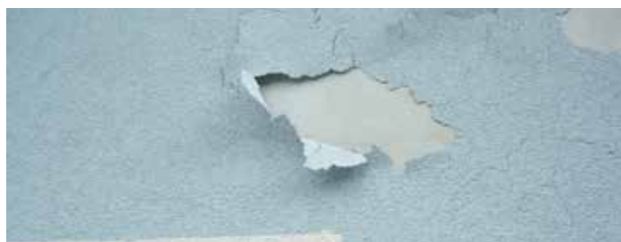
Fot. 2 a i b. Przykłady odspojenia tynku – mozaikowego i akrylowego
