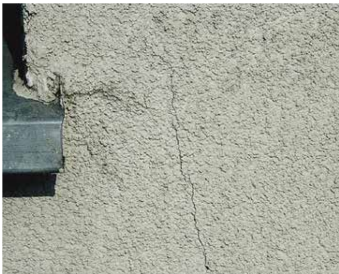
Fot. 3 a i b. Spękania, jakie pojawiają się na elewacji w wyniku odkształcenia warstw elewacyjnych, spowodowane cyklicznym nagrzewaniem i wychładzaniem się powierzchni elewacji
