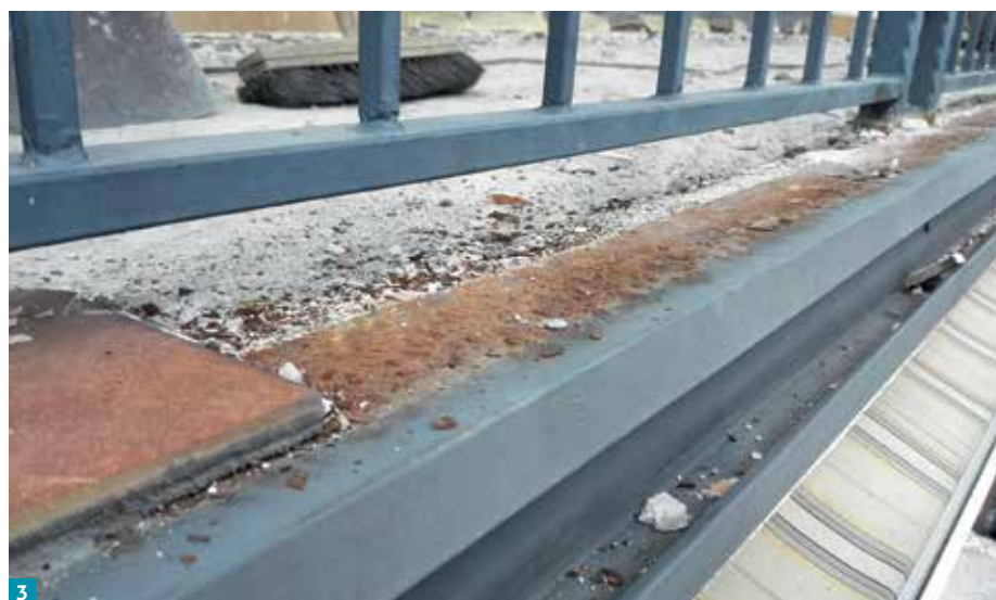
Korozja okapników po skuciu posadzki. Korozja obróbki nastąpiła ze względu na nie szczelność w strefie okapowej. Zdjęcie: firma Renoplast
