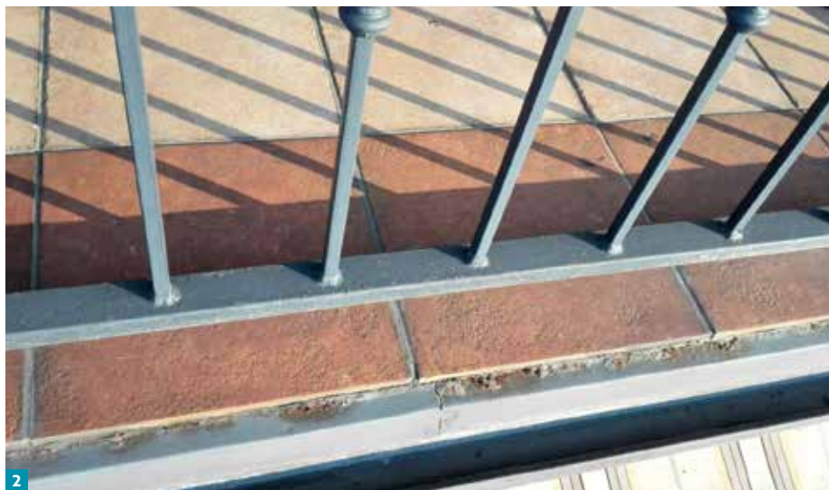
Korozja obróbki blacharskiej w strefie okapowej. Zdjęcie: firma Renoplast
