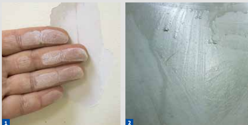
1 Niedostatecznie zagruntowane podłoże. 2 Efekt stosowania nierozcieńczonego gruntu.
