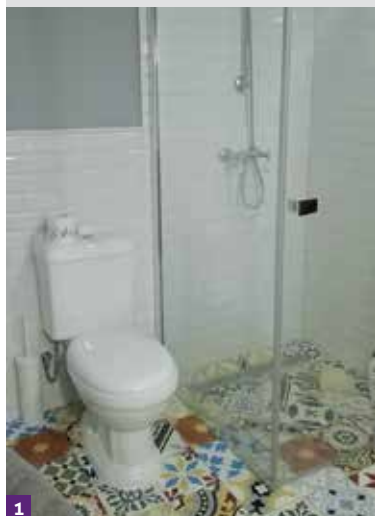
1 Muszla klozetowa zainstalowana w całkiem nowym miejscu.
