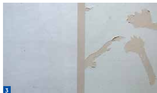
3 Porównanie farb emulsyjnych białych na jednokrotnie zagruntowanej gładzi. Oderwanie taśmy pokazuje niejednorodną przyczepność farb.
