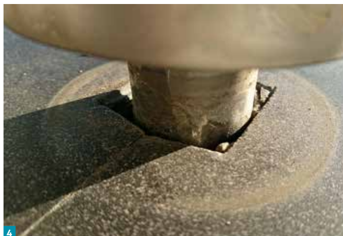
4 Niewłaściwe zamontowanie słupka balustrady. Brak uszczelnień pod ringiem słupka.
