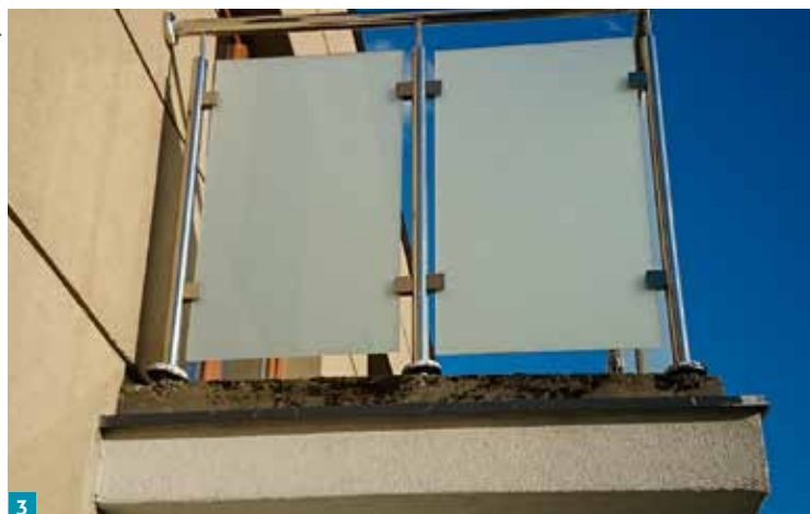
3 Postępująca degradacja niewykończonych powierzchni balkonu.
