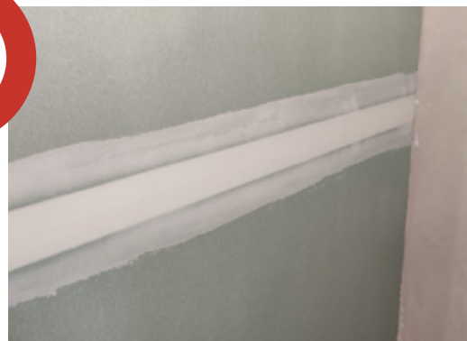
Łączenie na ścianie na fizelinie, płyta klejona – brak ugięć czy spękań przy GTA.
