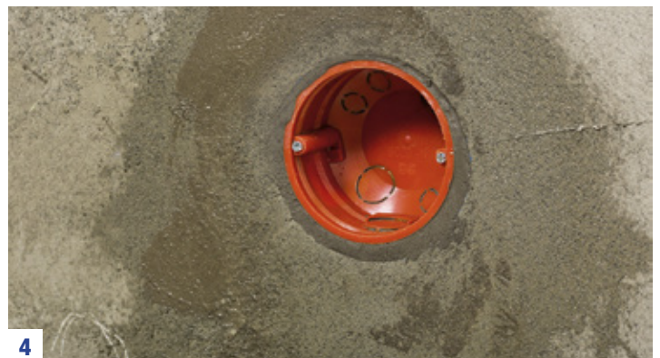
4 Obsadzona puszka elektryczna.
