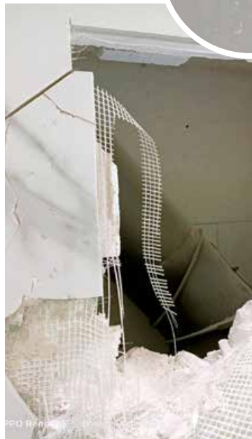
FOT. 6 Próbka delikatnego odkucia czołowej płytki wielkoformatowej skończyła się uszkodzeniem obudowy z płyt silikatowych.
