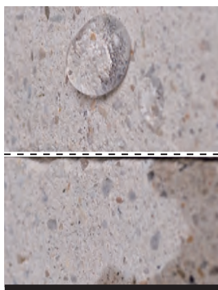
powierzchnie piaskowca, cegły, tynków
