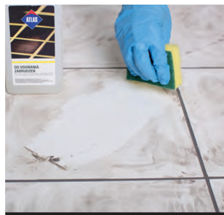
zabrudzenia po fugach epoksydowych
