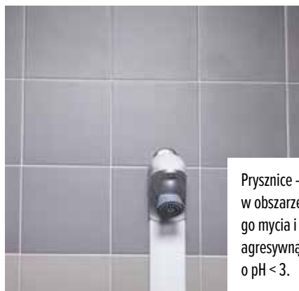
Łazienka – fuga w obszarze intensywnego, mechanicznego mycia i czyszczenia agresywną chemią o pH < 3.
