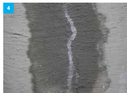
Zamknięcie rysy przez kryształy soli, brak sączenia.
