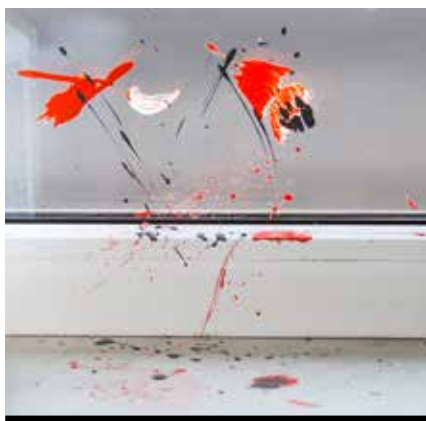
zabrudzenia po farbach, gruntach i tynkach
