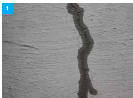
Aktívna netesnosť na mieste trhliny v podklade.
