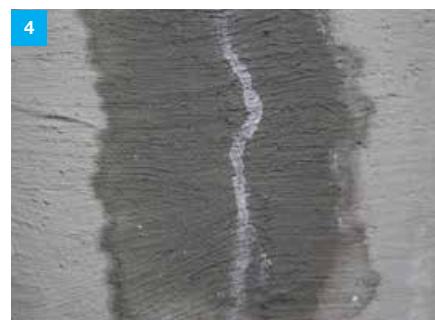
4 Uzavření trhlin krystaly soli, bez prosakování.
