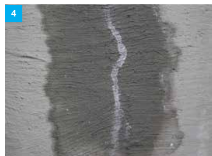
Zamknięcie rysy przez kryształy soli, brak sączenia.
