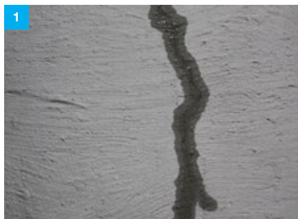
Aktívna netesnosť na mieste trhliny v podklade.
