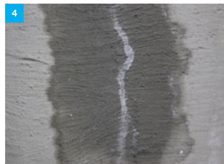
Uzavretie trhlín kryštálmi soli, bez presakovania.
