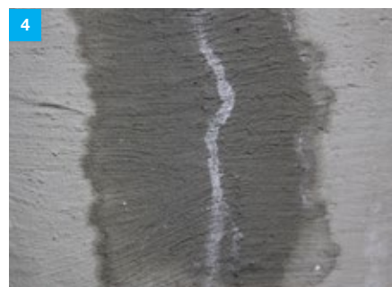
Uzavření trhlin krystaly soli, bez prosakování.
