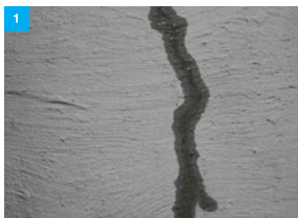
Aktivní netěsnost na místě trhliny v podkladu
