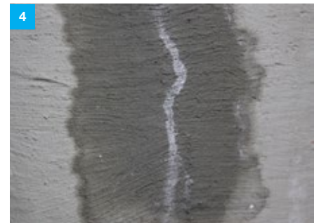
Schließen des Risses durch Salzkristalle, kein Sickerwasser.
