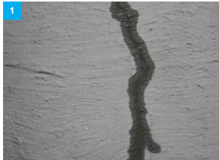
Leckage an einem Riss im Untergrund.
