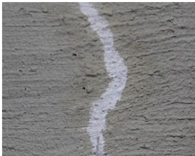
Fot. 4. Uzavretie trhliny kryštálmi soli, bez úniku vody. Účinok po 21 dňoch.
