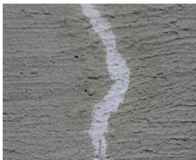
Фот. 4. Закрытие трещины кристаллами соли, просачивания нет. Эффект через 21 дней.
