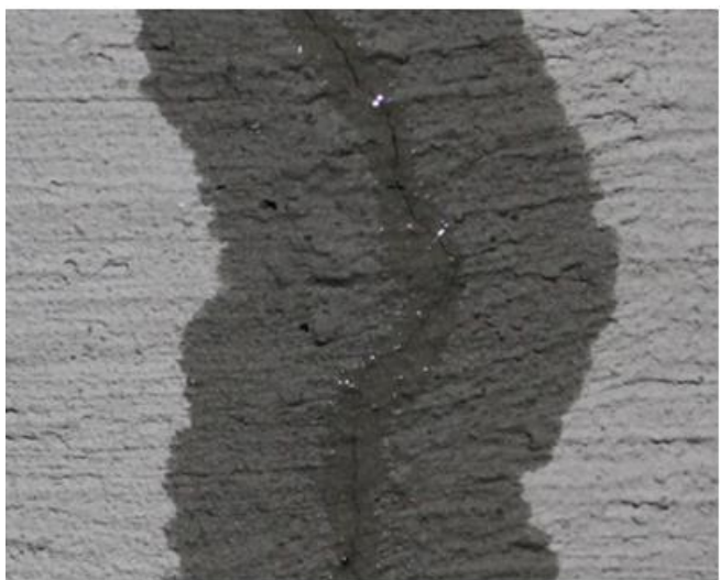
2 nuotr. Izoliacinė danga pamažu ima drėkti įtrūkio atsiradimo vietoje.
