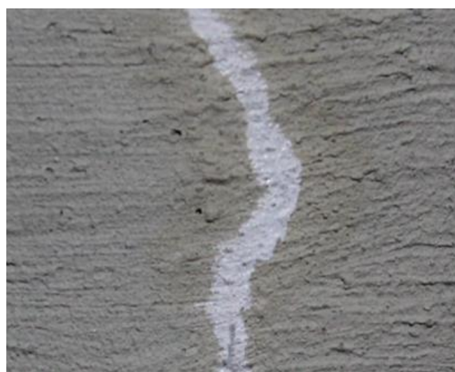
Фот. 4. Заповнення тріщини кристалами солі, відсутність просочування. Ефект через 21 день.
