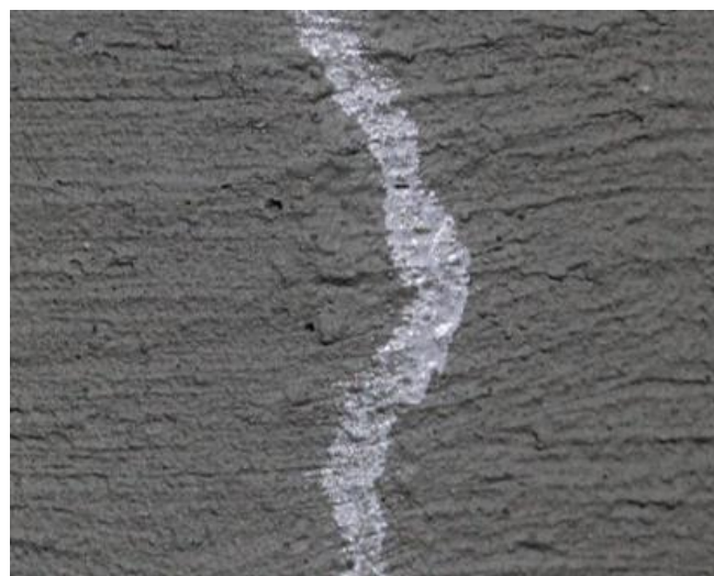
Фот. 5. Повільне накопичення кристалів солі на поверхні тріщини, додаткове ущільнення. Ефект через 35 днів.
